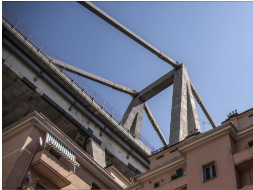
Une portion du pont Morandi, qui s'est effondré le 14 août 2018 à Gênes, en Italie. MARCO BERTORELLO / AFP
